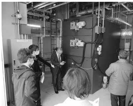
▲バイオマスボイラー
