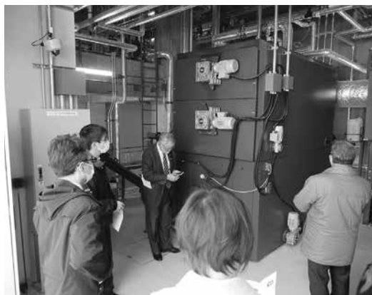
▲バイオマスボイラー
