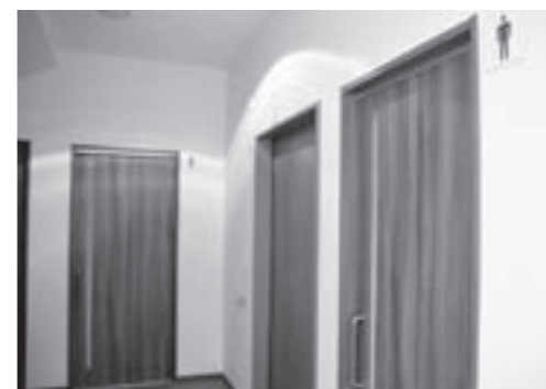
▲車いすで利用できる引き戸のトイレ
