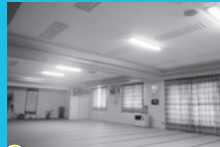
4 非常用の照明が使えます!
