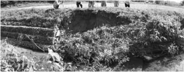
栃谷川被災現場
