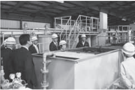
管理型最終処分場の浸出水処理施設
