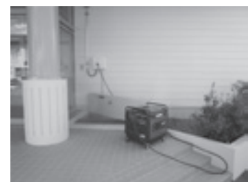
青葉区会館（発電機接続状況）
