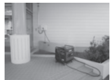
青葉区会館（発電機接続状況）
