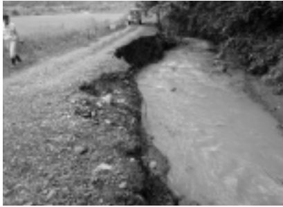
8月豪雨による被害箇所
